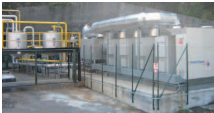
Figura 2. Heat & Power: cogenerazione alimentata a biogas da depurazione acque reflue presso Mediterranea delle Acque – Genova. Microturbine 260 kWe
